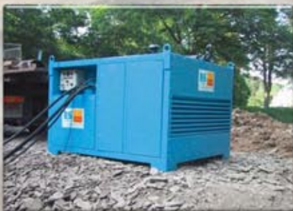
Le générateur électrique d'alimentation
